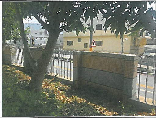
堆滿落葉的圍牆內邊坡
